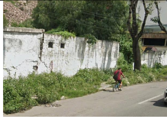
Fotografía 4: La banqueta se ve invadida por herbáceas y se observa presencia de basura en entradas de pozos de visita, con ruptura de tapa de estos.
