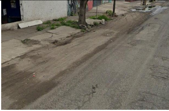
Fotografía 3: Se observan ruptura de losas de banquetas y levantamientos localizados, así como la falta de pintura en pavimento.
